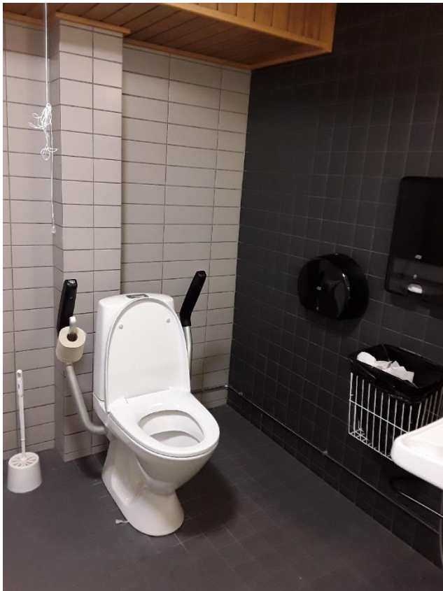
Kuva 12. WC-istuimelle ei pääse siirtymään molemmilta puolilta ja istuimen takana ei ole tilaa avustajalle. Kuva Urheilupuiston esteettömästä wc:stä.
