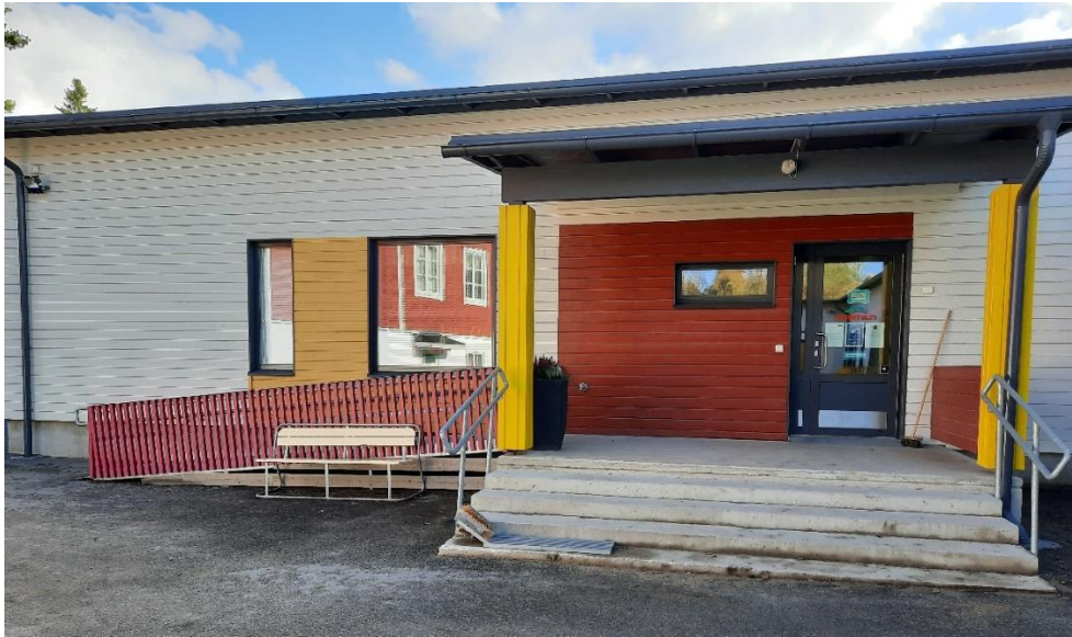
Kuva 11. Monista tarkastelluista portaista puuttuvat kontrastiraidat ja käsijohteet eivät jatku riittävän pitkälle portaan yli. Kuvassa Naisvuoren päiväkodin Revontulten sisäänkäynti.
